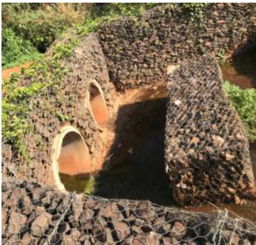
Figura 13 - Presença de descarte de efluentes no P1.
